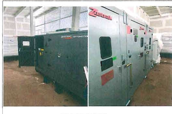
F2: Equipos eléctricos en azoteas
