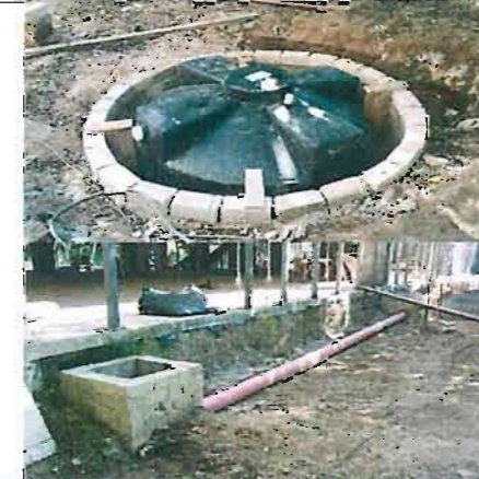
(06) Biodigestor y (07) Registros
