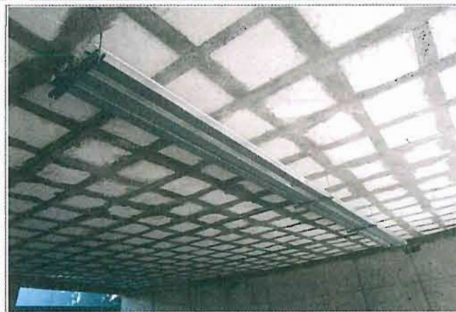
F4: Ducto eléctrico sobre plafón
